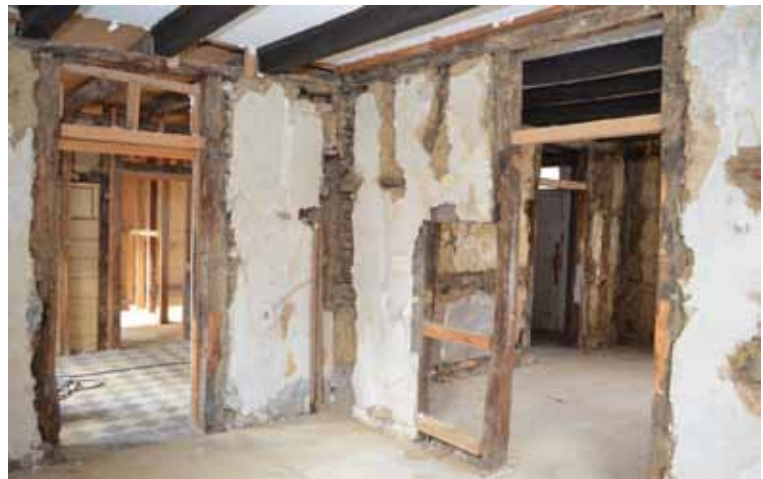
Bilder aus dem Inneren des Hauses zeigen den sanierungsbedürftigen Zustand und lassen das Ausmaß der anfallenden Arbeiten erahnen.
